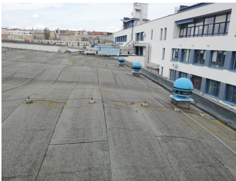
zdjęcie 3 Koryta dachowe wykonstruowane i wyłożone z papy po całej długości dachu
