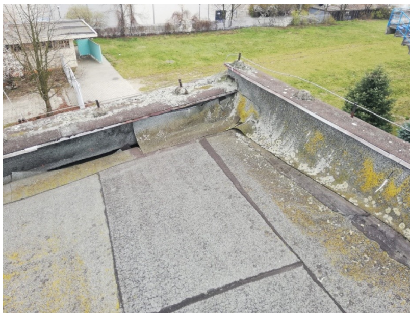
zdjęcie 2 Stan obecny opierzenia i pokrycia - obwodowo pod zamontowanym wywinięciem z papy na murek attyki występują braki izolacji termicznej do uzupełnienia
