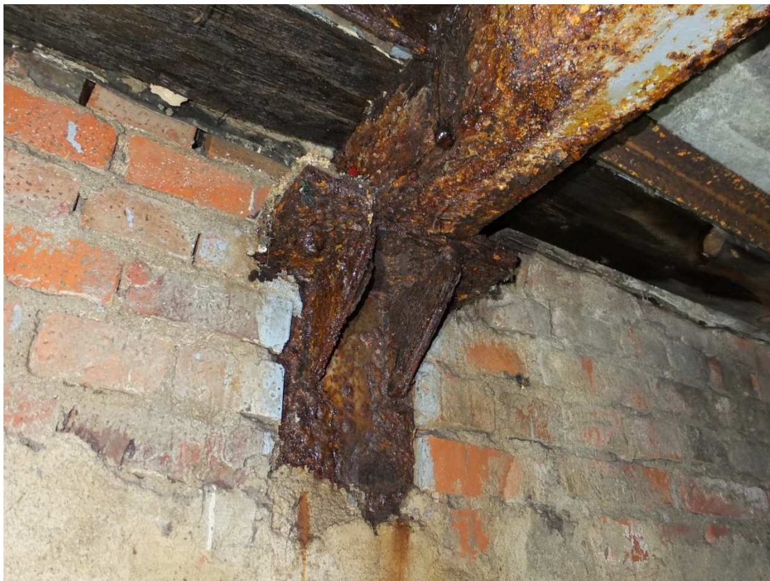
Fot. Nr27 (skorodowana konstrukcja wsporcza płyty żelbetowej plaży)
