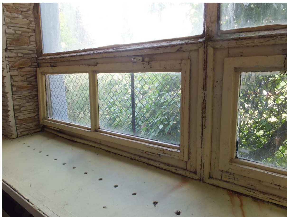
Fot. Nr22 (fatalny stan techniczny okien budynku pływalni – okna posiadają pojedynczą szybę)
