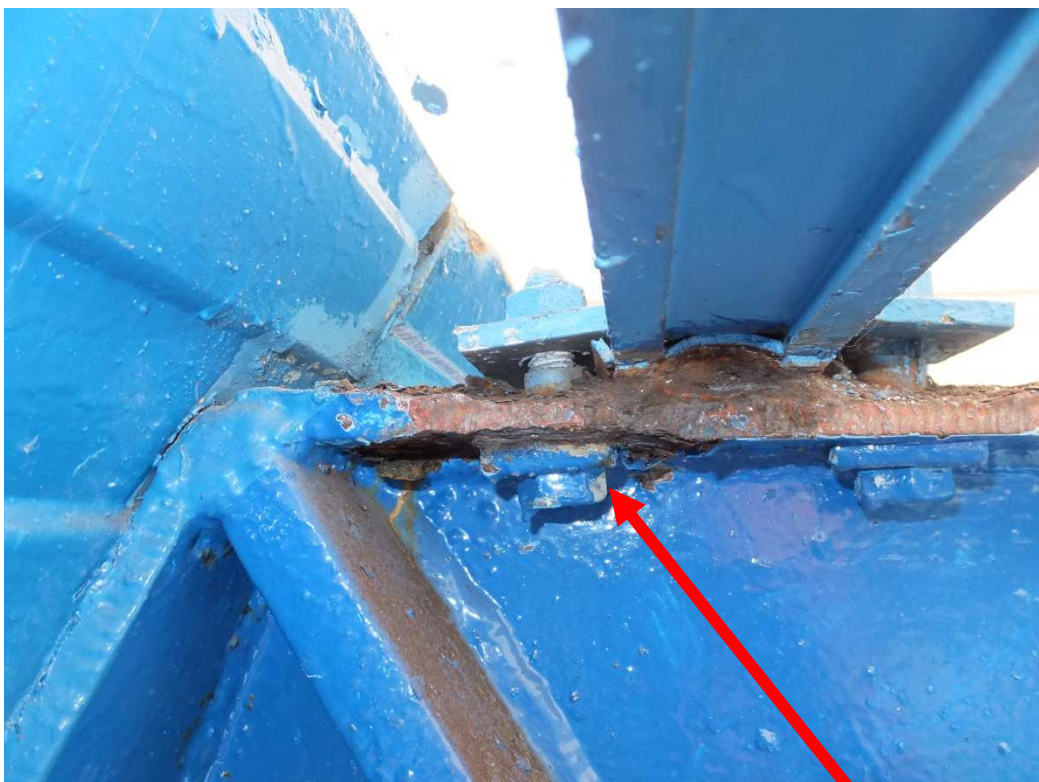
Fot. Nr10 (patrz odnośnik na Fot. Nr9) Czerwona strzałka pokazuje miejsce ubytku około 50% rozciąganego przekroju pasa górnego naroża ramy stalowej
