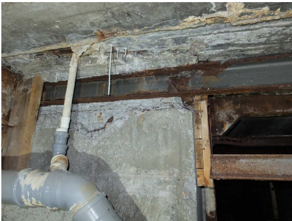
Fot. Nr28 (obraz destrukcji płyty żelbetowej plaży)
