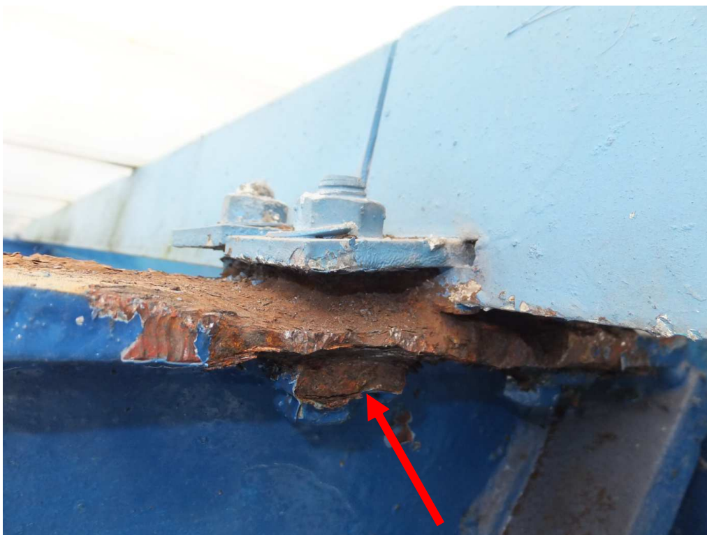
Fot. Nr8 (korozja spowodowała ubytek ~75% powierzchni przekroju pasa ściskanego dźwigara)
