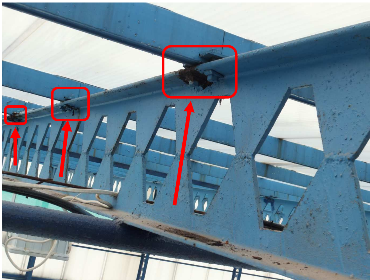
Fot. Nr5 (czerwone strzałki wskazują mocne punktowe ogniska korozji)
