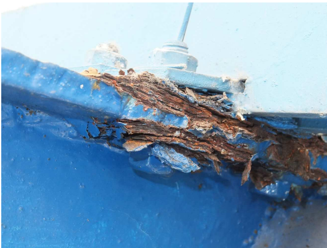
Fot. Nr6 (bardzo mocno skorodowany pas górny dwuteownika ramy nośnej konstrukcji przekrycia pływalni)
