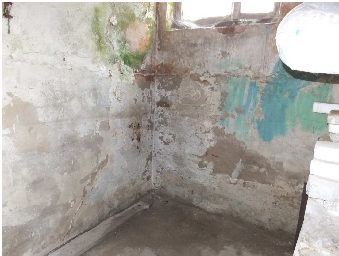
Fot. Nr24 (zagrzybiałe i odpadające tynki wewnętrzne)
