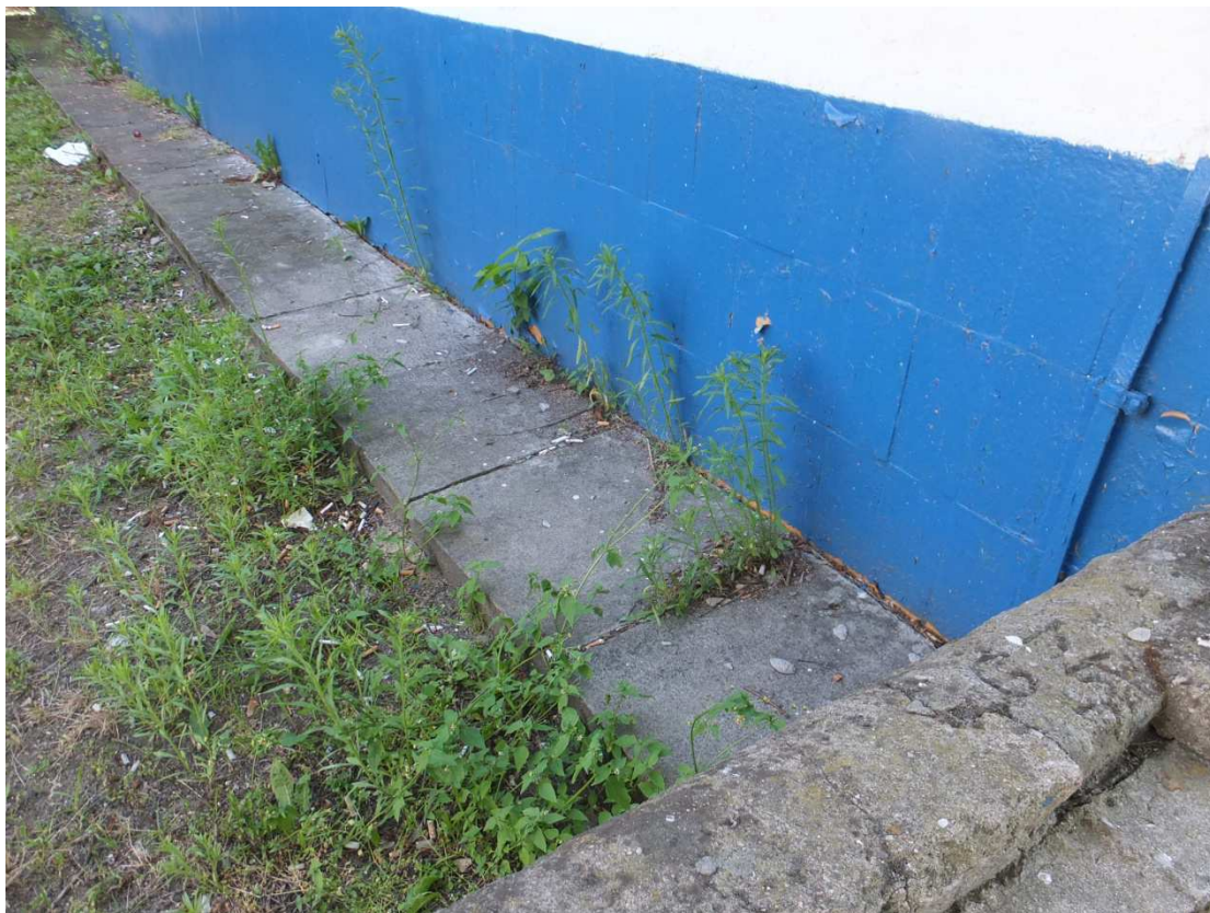
Fot. Nr23 (brak izolacji pionowej i poziomej zewnętrznych ścian budynku)
