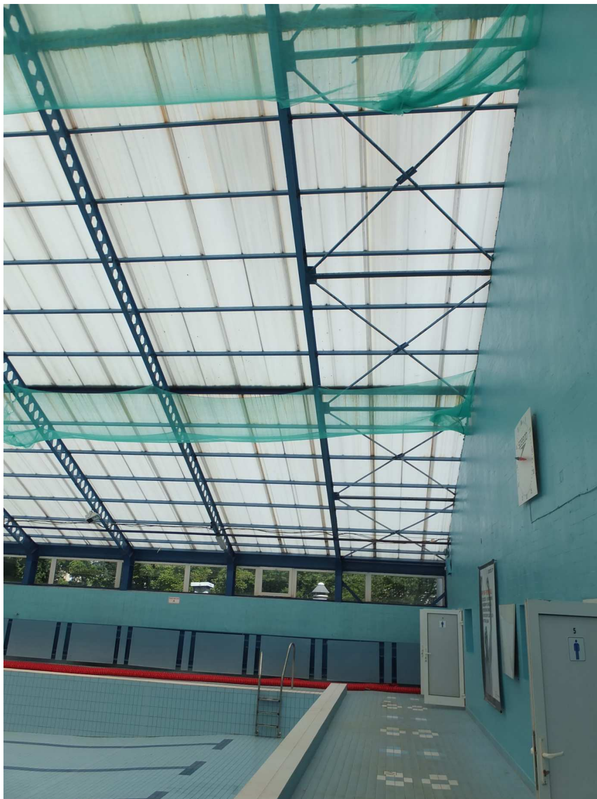
Fot. Nr3 (stężenie połączeniowe w sąsiedztwie ściany szczytowej)
