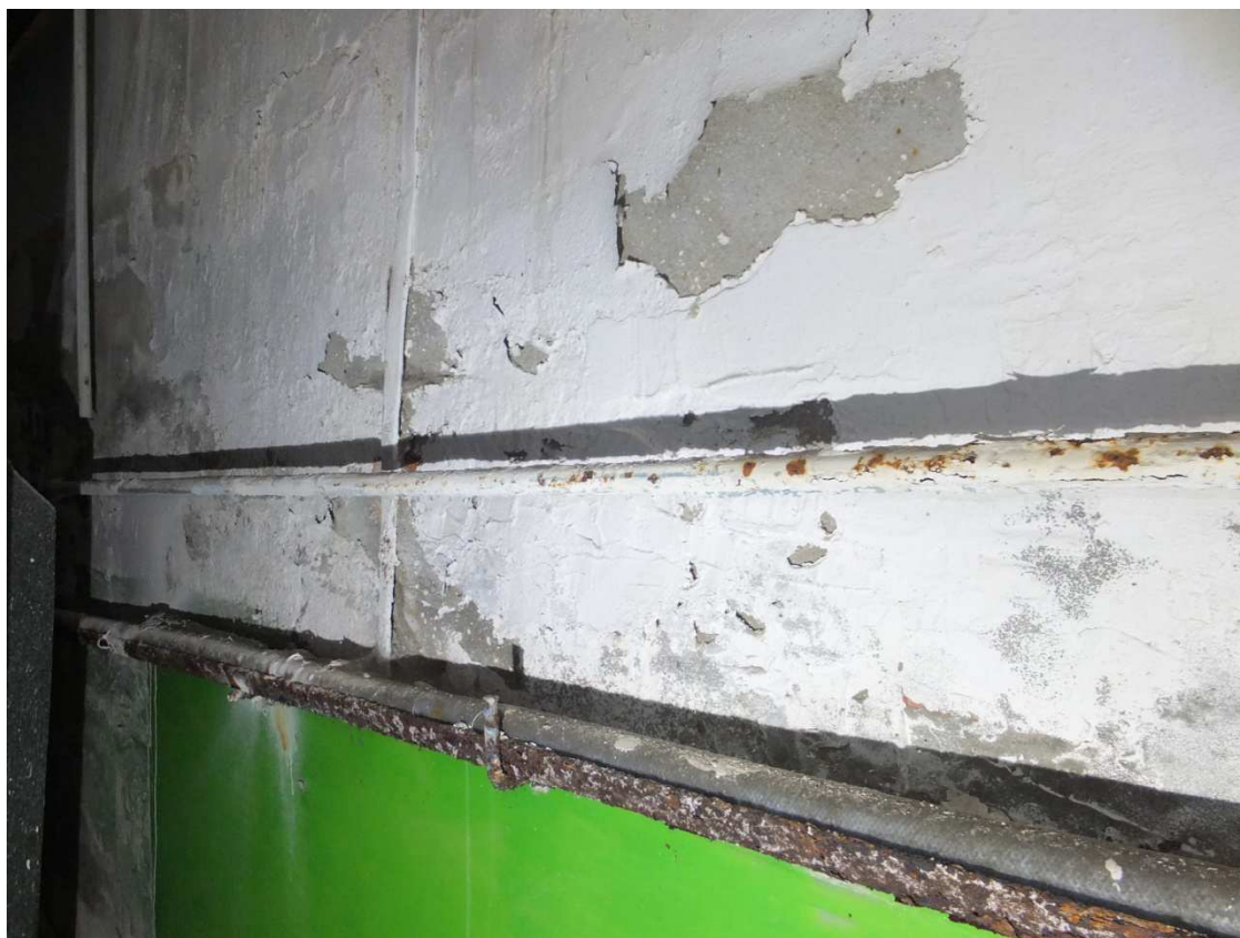
Fot. Nr25 (zagrzybiałe i odpadające tynki wewnętrzne)
