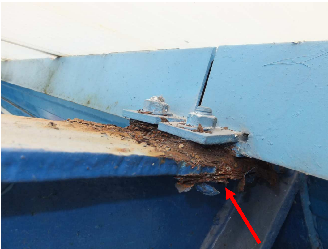
Fot. Nr7 (korozja spowodowała ubytek ~50% powierzchni przekroju pasa ściskanego dźwigara)
