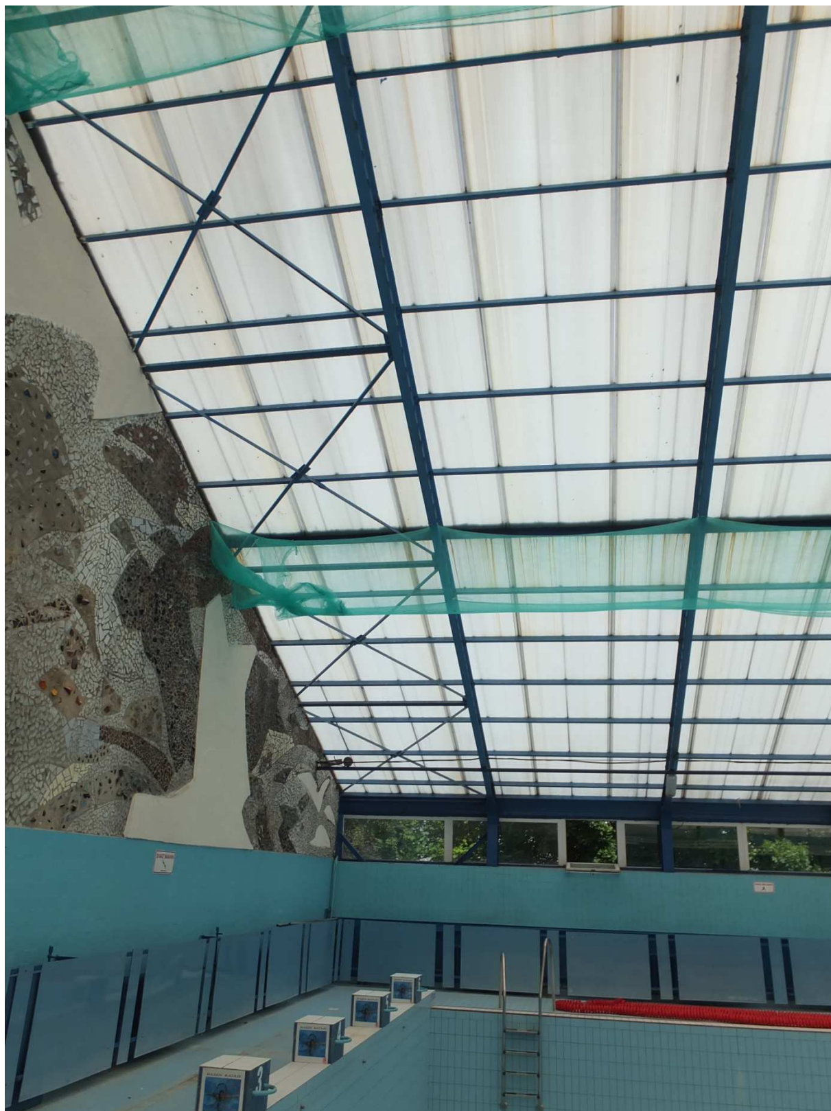
Fot. Nr2 (stężenie pościowe w sąsiedztwie ściany szczytowej)
