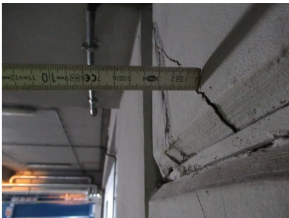
Fot. 26 - 2018 r. - ... oraz skrzywienie. Zalecenie: konsultacja z konstruktorem i opracowanie sposobu naprawy
