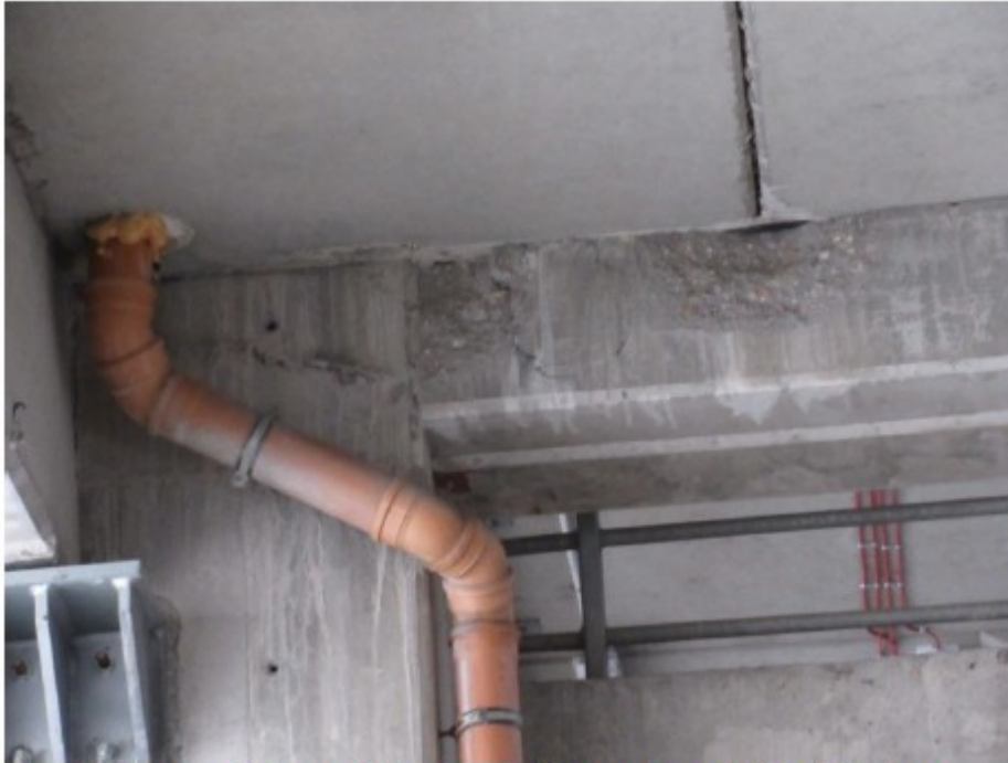
Fot. 13- 2018 r. - należy usunąć luźne fragmenty betonu i uzupełnić ubytki betonu
