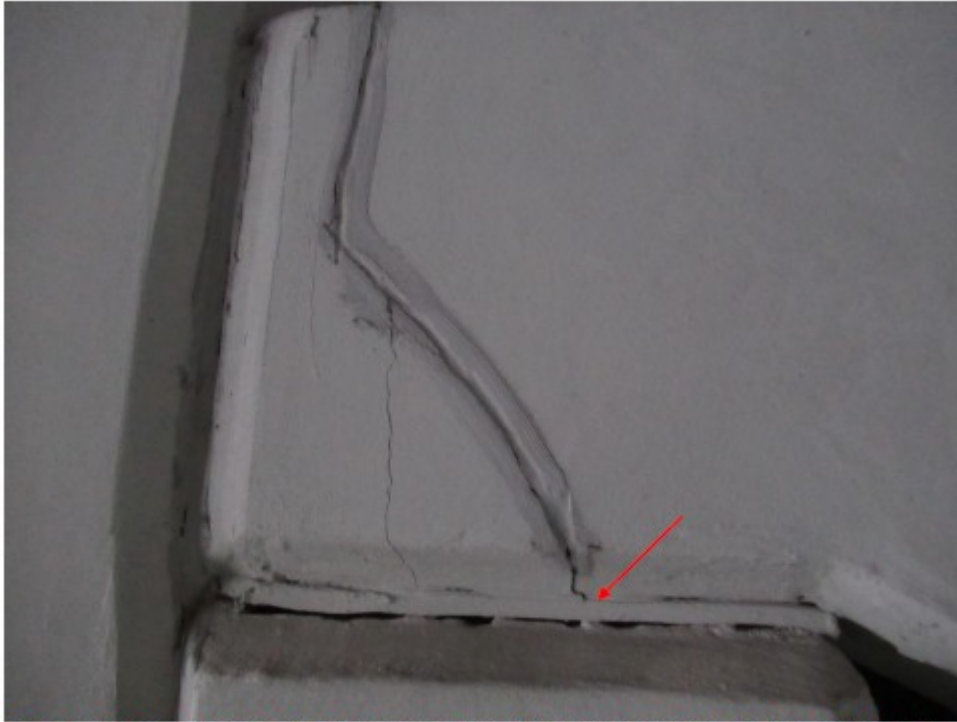
Fot. 28 - 2018 r. - nastąpiło dalsze rozwarście rysy. Zalecenie: konsultacja z konstruktorem i opracowanie sposobu naprawy
