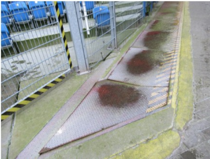
Fot.46 - 2018 r. - zagięte blachy najazdowe przekrycia kanału
