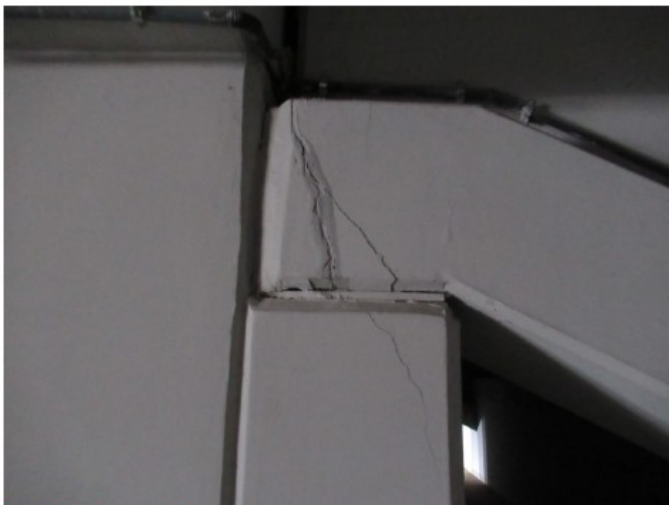
Fot. 25 - 2018 r. - nastąpiło powiększenie zarysowania !
