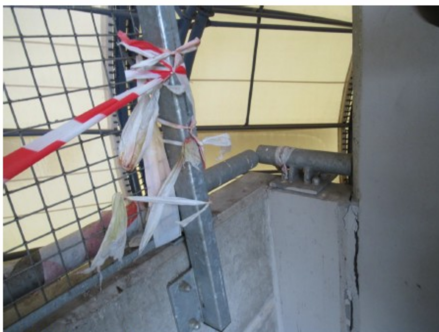
Fot.43 - 2018 r. - brak siatki osłonowej, zabezpieczającej
