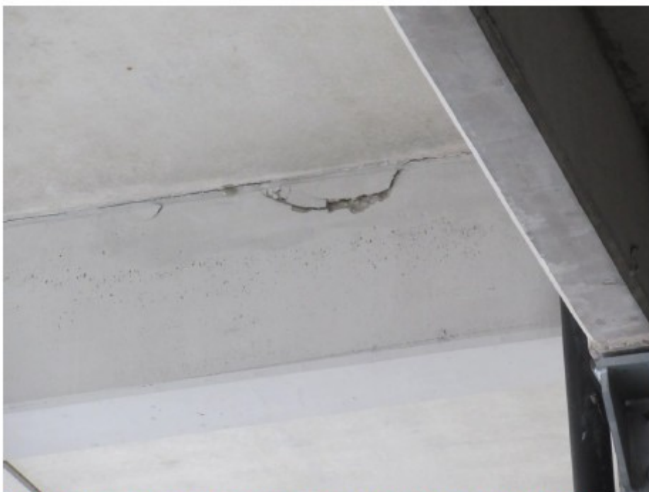
Fot.11- 2018 r. - należy usunąć luźne fragmenty betonu i uzupełnić ubytki betonu
