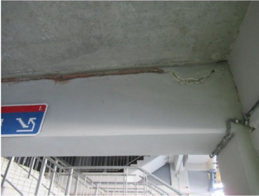
Fot.2 - 2018 r. - należy usunąć luźne fragmenty betonu i uzupełnić ubytki betonu
