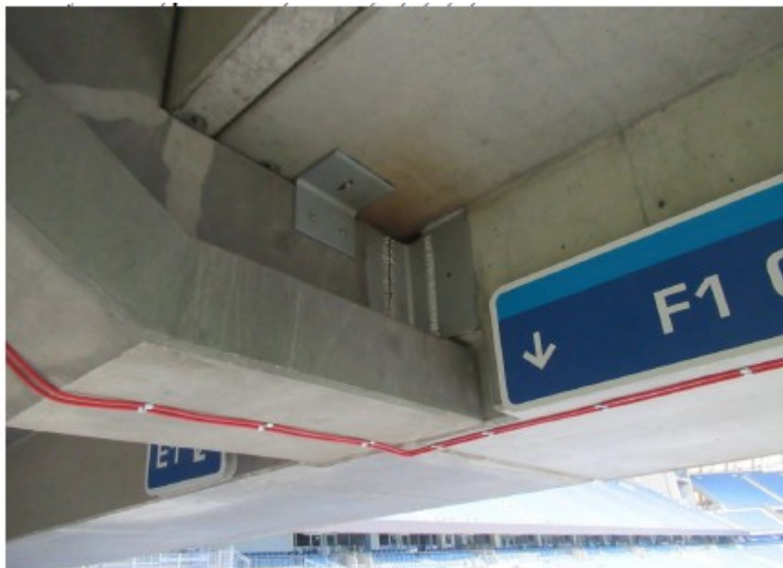
Fot. 58 -2018 r. - uszkodzenie marek stalowych połączenia belek na dylatacjach
