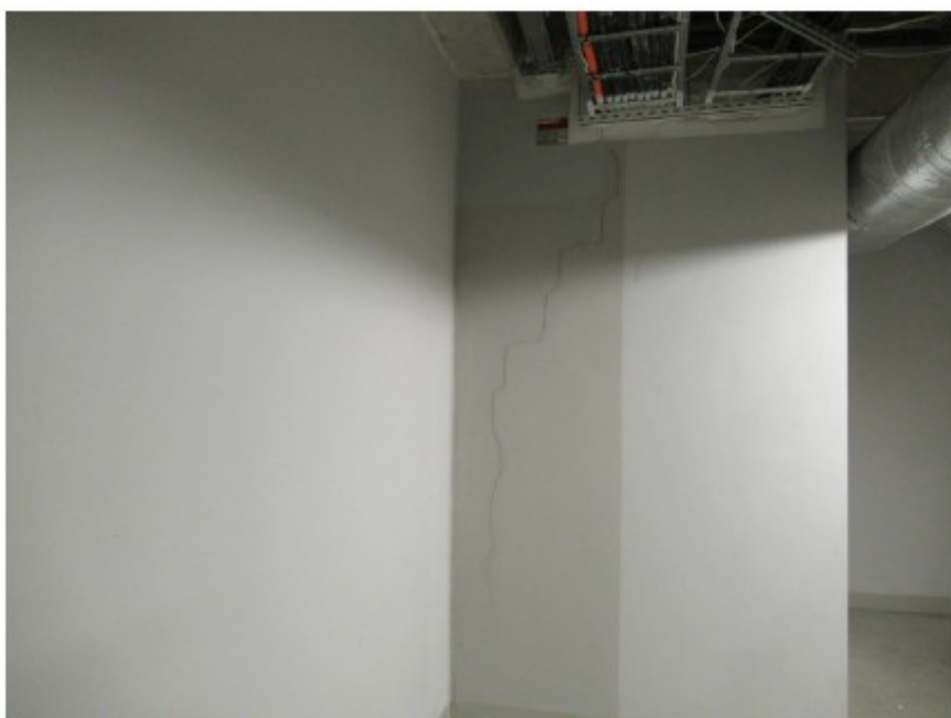
Fot.40 - 2018 r. - zarysowanie ściany pom. technicznego przy dylatacji
