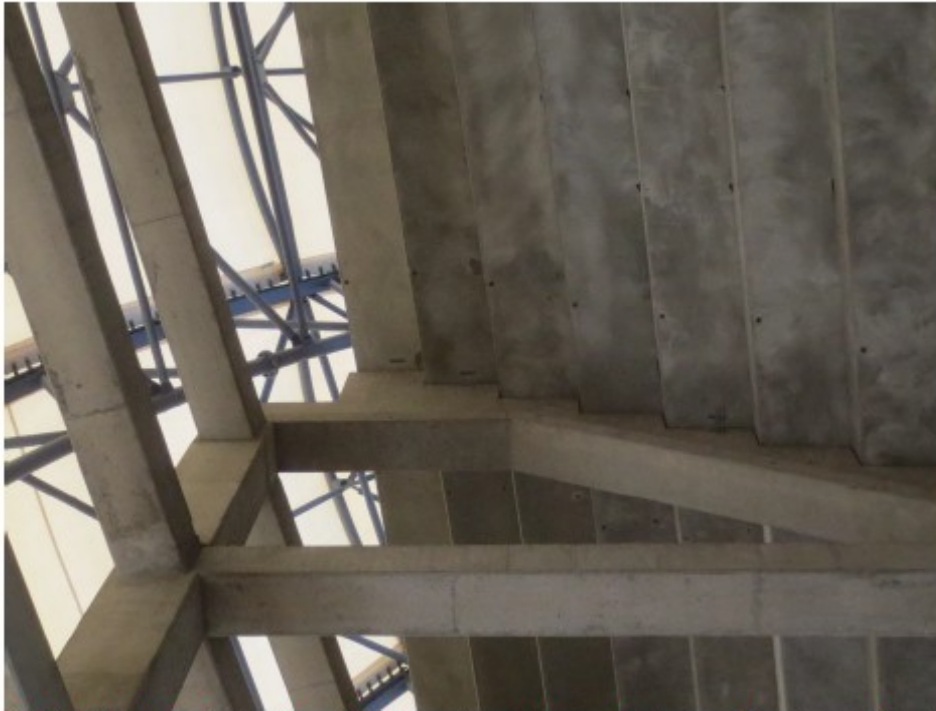
Fot.21- 2018 r. - brakujące łączniki stalowe nie zostały uzupełnione. - zalecenie uzupełnienia
