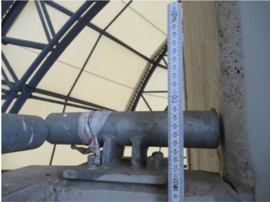
Fot.44 - 2018 r. - nieprawidłowa wysokość istniejącej balustrady 109 cm, wymagane : 110 cm
