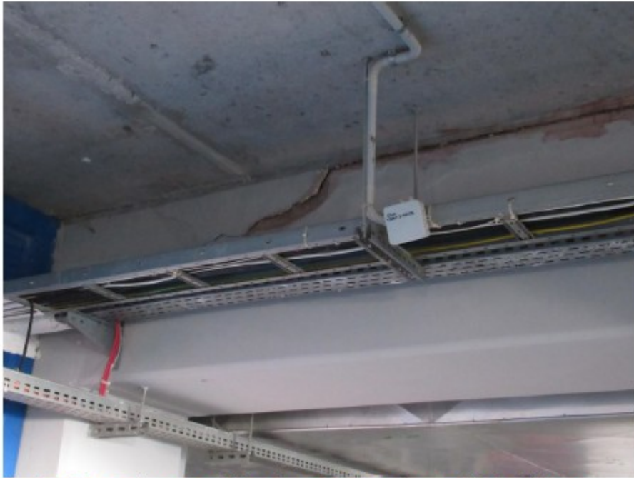
Fot.5 - 2018 r. - należy usunąć luźne fragmenty betonu i uzupełnić ubytki betonu
