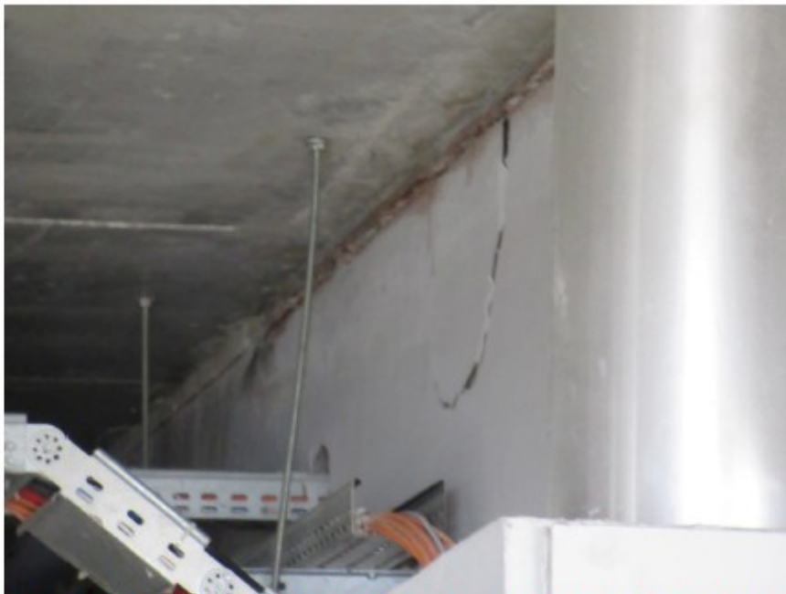
Fot.3 - 2018 r. - Inny fragment tej samej belki - nowe uszkodzenie - należy usunąć luźne fragmenty betonu i uzupełnić ubytki betonu
