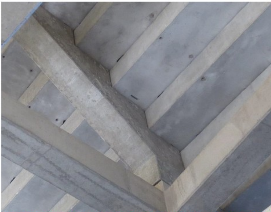
Fot.17 - 2018 r. - brakujące łączniki stalowe nie zostały uzupełnione. - zalecenie uzupełnienia
